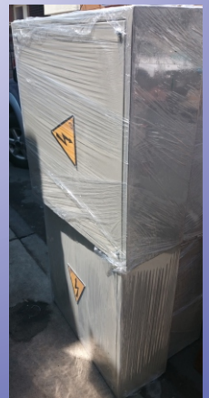
CAJAS DE PASO BAJA Y MEDIA TENSION
