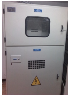
Celda de Medida en MT
