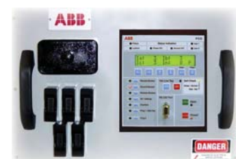
Bastidor de montaje en subestación
